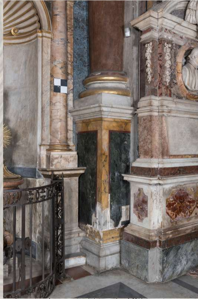
Basamento colonna navata sinistra prima dell'intervento
